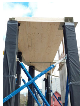
CLT på søjler af limtræ og skruet godt samme med præmonterede stålbeslag. Foto: CLT Denmark
